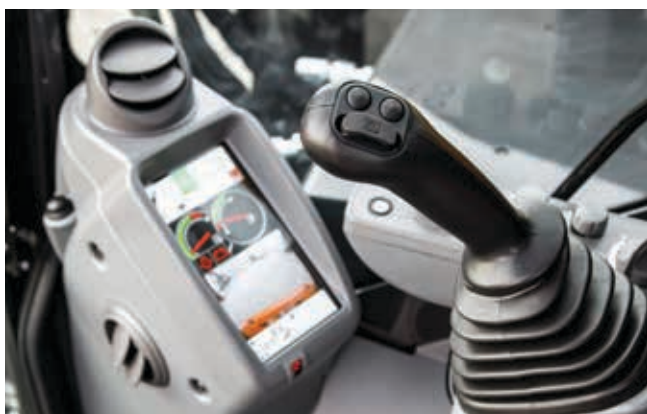
I comandi e il monitor sono facilmente raggiungibili.
